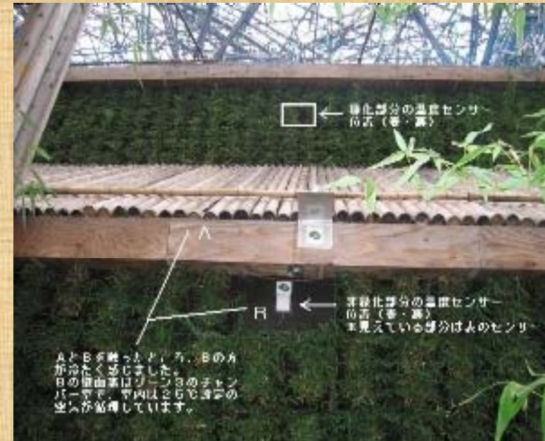
Sunlight sensor and wall temp sensor 外壁の温度センサー、日照計
