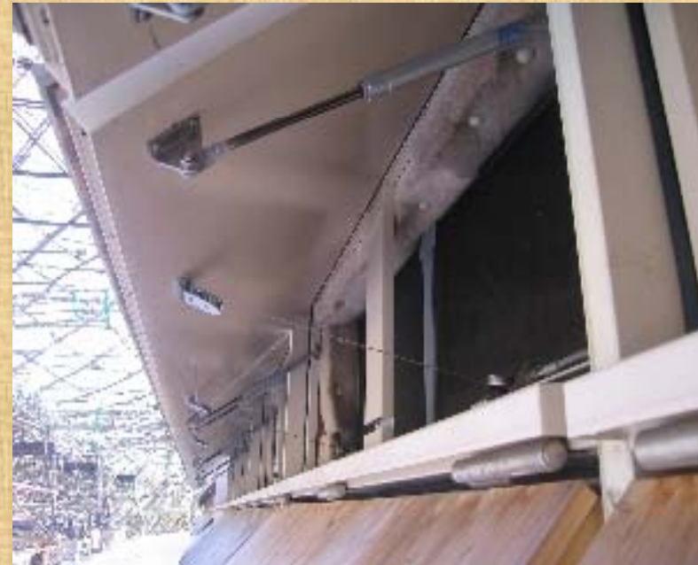
排煙窓を兼ねる開閉用ダンパー
